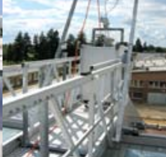
Passerelle équipée d'une nacelle individuelle.
