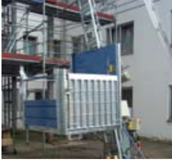
Plateforme de transport installée sur ouvrage incliné.
