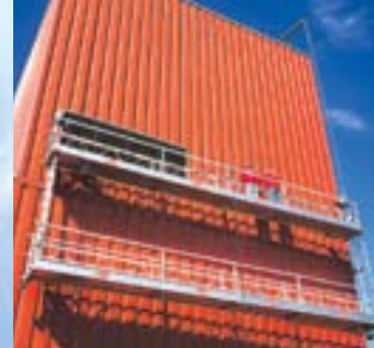
Plateforme suspendue à double niveau.
